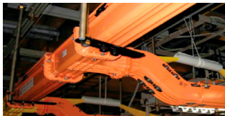
Canalizaciones o rutas de la fibra | CommScope
